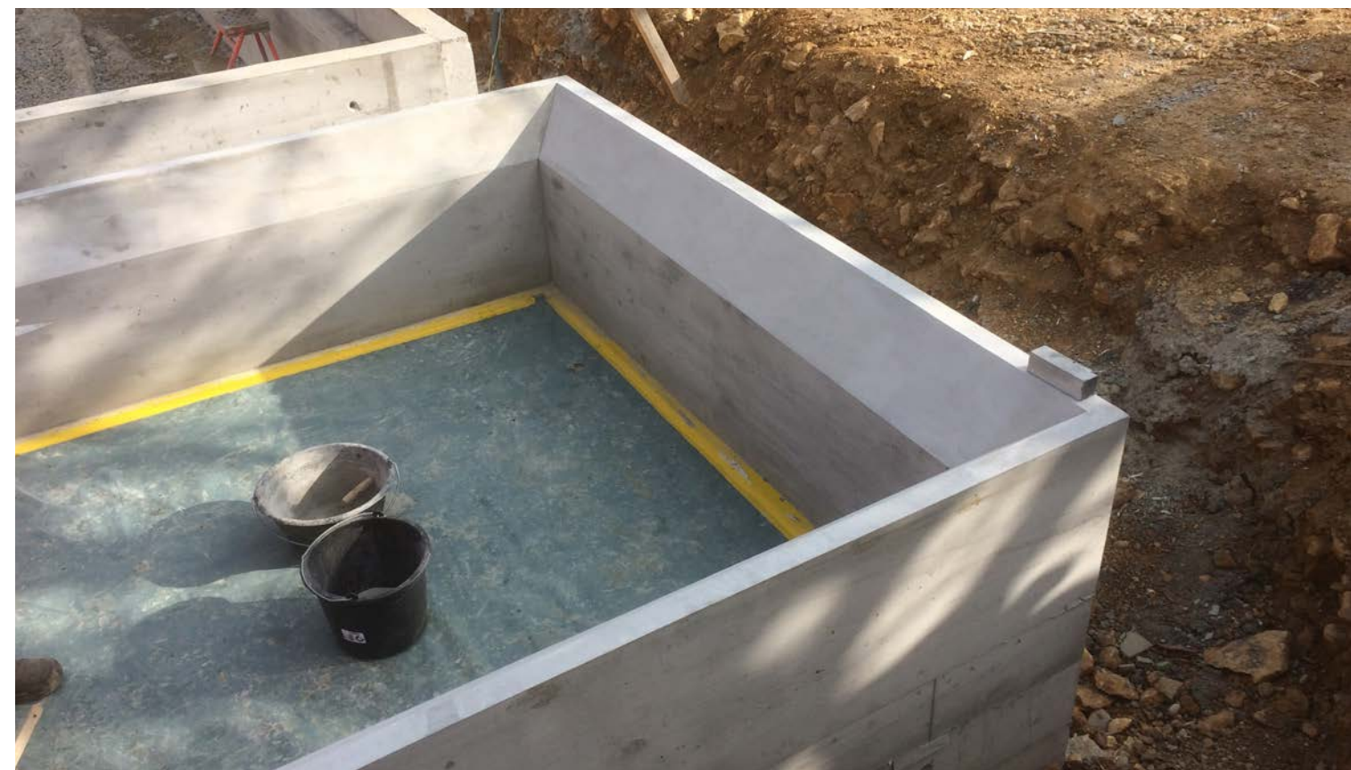
BRUNNEN-BASSIN / OBERBUECHWEG 218, WENSLINGEN Betonkosmetik
