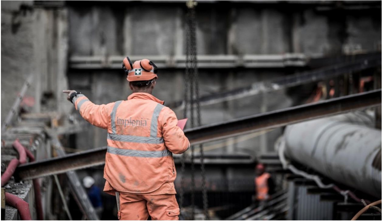
Implenia réalise deux nouveaux îlots (B4 et B5) pour CFF Immobilier SA sur le grand complexe Pont Rouge à la Praille. Les travaux sur l'îlot B1 avancent comme prévu. (Photo: Implenia)
