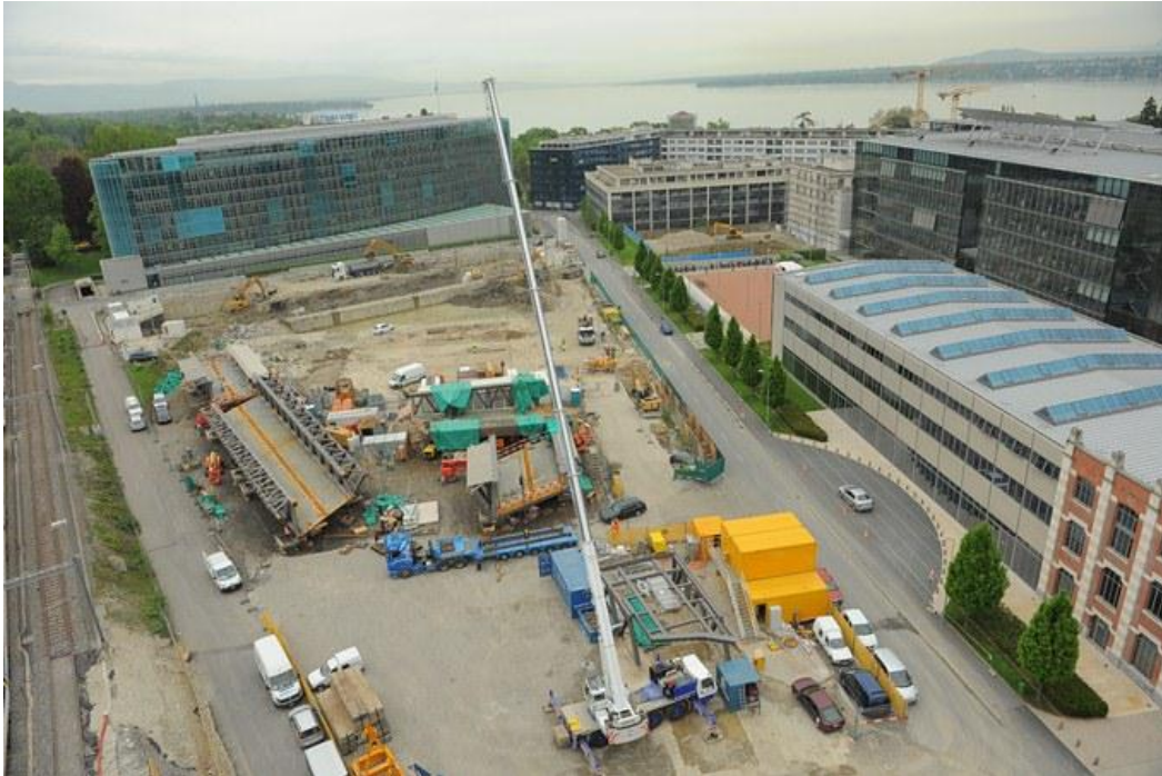
Le chantier du nouveau siège social international de JTI a démarré le 16 avril 2012. (Copyright : JTI)
