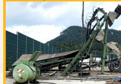
Nach dem Kollaps
