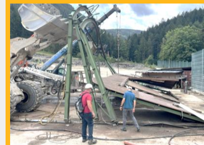
Nach dem Kollaps
