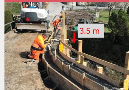
Auf dieser Schalung befanden sich ungesicherte Mitarbeitende. Potenzielle Absturzhöhe: 3.5 m.
