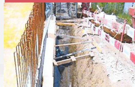
Sieht klein aus, hat aber das Potenzial zu töten: Böschung ohne Sicherung bzw. Sicherungsnachweis..
